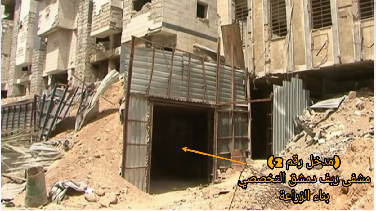
١٣- تظهر في الصورة مشفى ريف دمشق التخصصي (النقطة واحد) المحصنة بشكل كامل، والتي تقع تحت بناء الزراعة قرب دواء الشهداء بمدينة دوما في الغوطة الشرقية.
